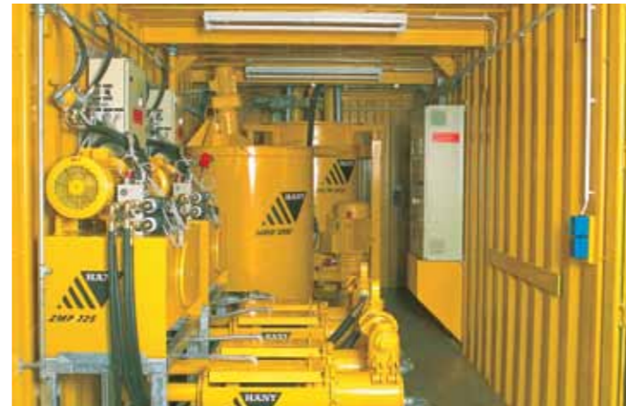
Фиг. 24. Инсталация за смесване на почви за приготвяне на разтвор за две сондажни устройства Figure 24. Plant for soil mixing for the supply of grout for two drill rigs.
