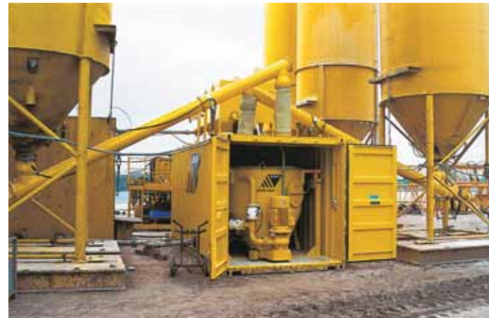
Фиг. 23. Напълно автоматизирана смесителна инсталация за производство на суспензия за мембранни стени. Напацитет: 50 м 3 /час Figure 23. Fully automated mixing plant for slurry wall suspension. Capacity: 50 m 3 /hr
