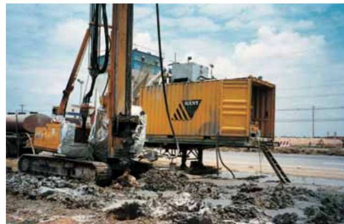
Фиг. 25. Инсталация за смесване на почви за проект на магистрала в Банкок, Тайланд Figure 25. Soil mixing plant for Highway project in Bangkok, Thailand.
