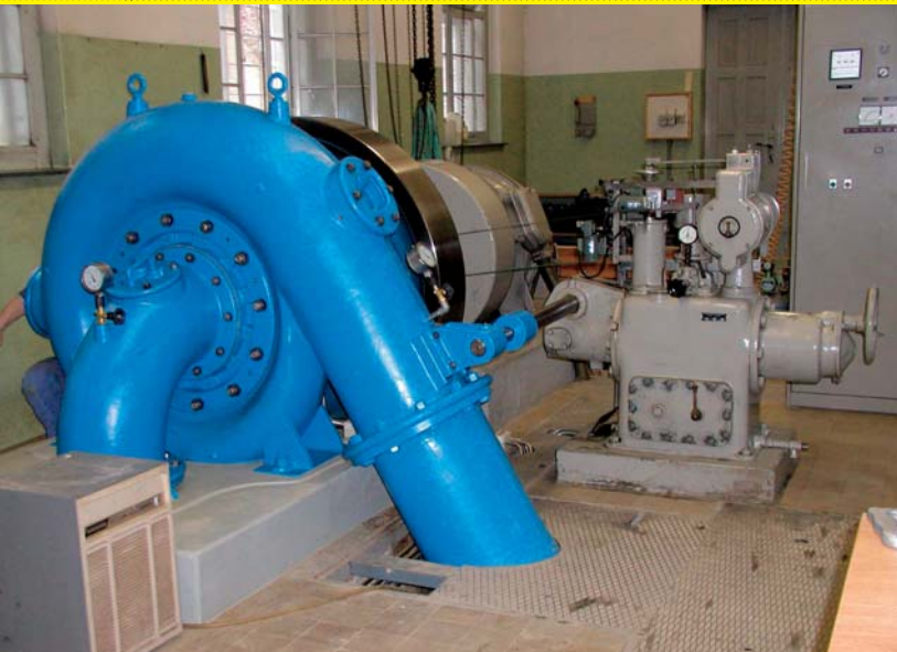
BEWÄHRTE TECHNIK: alte Francisturbine
