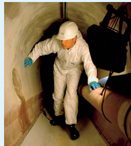
Dem Kanal wird mit dem Kanalwärmetauscher Wärme entzogen. Bild 5 Foto: EBM, Münchenstein (CH)
