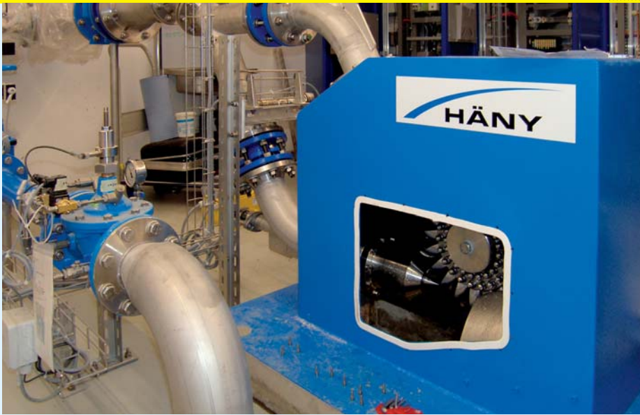
TURBINE FÜR TRINKWASSER: Bild 6 auch Wasserversorgungs- unternehmen im Flachland können Strom erzeugen.
