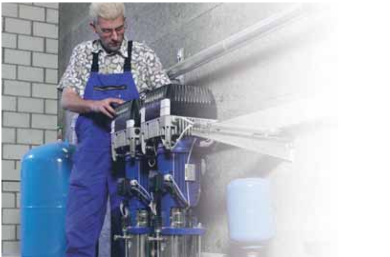
Druckerhöhungsanlage mit Hydrovar-Antrieb
