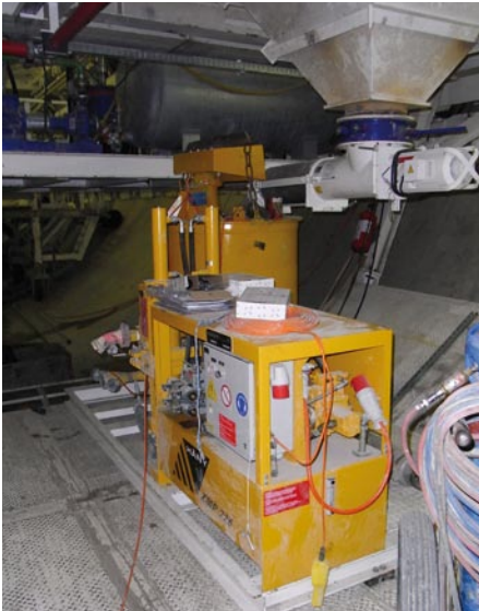
Auf dem TBM-Nachläufer (Weinbergtunnel) zum Transport von Injektionsmörtel installierte ZMP 725 Häny-Pumpe mit HRW 800 Rührwerk.
