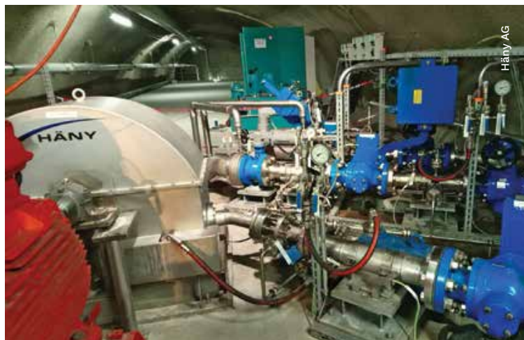
Centrale de Sedrun: turbogroupe Pelton à axe horizontal et un injecteur valorisant les débits de drainage des tunnels de la région de Sedrun (GR)
