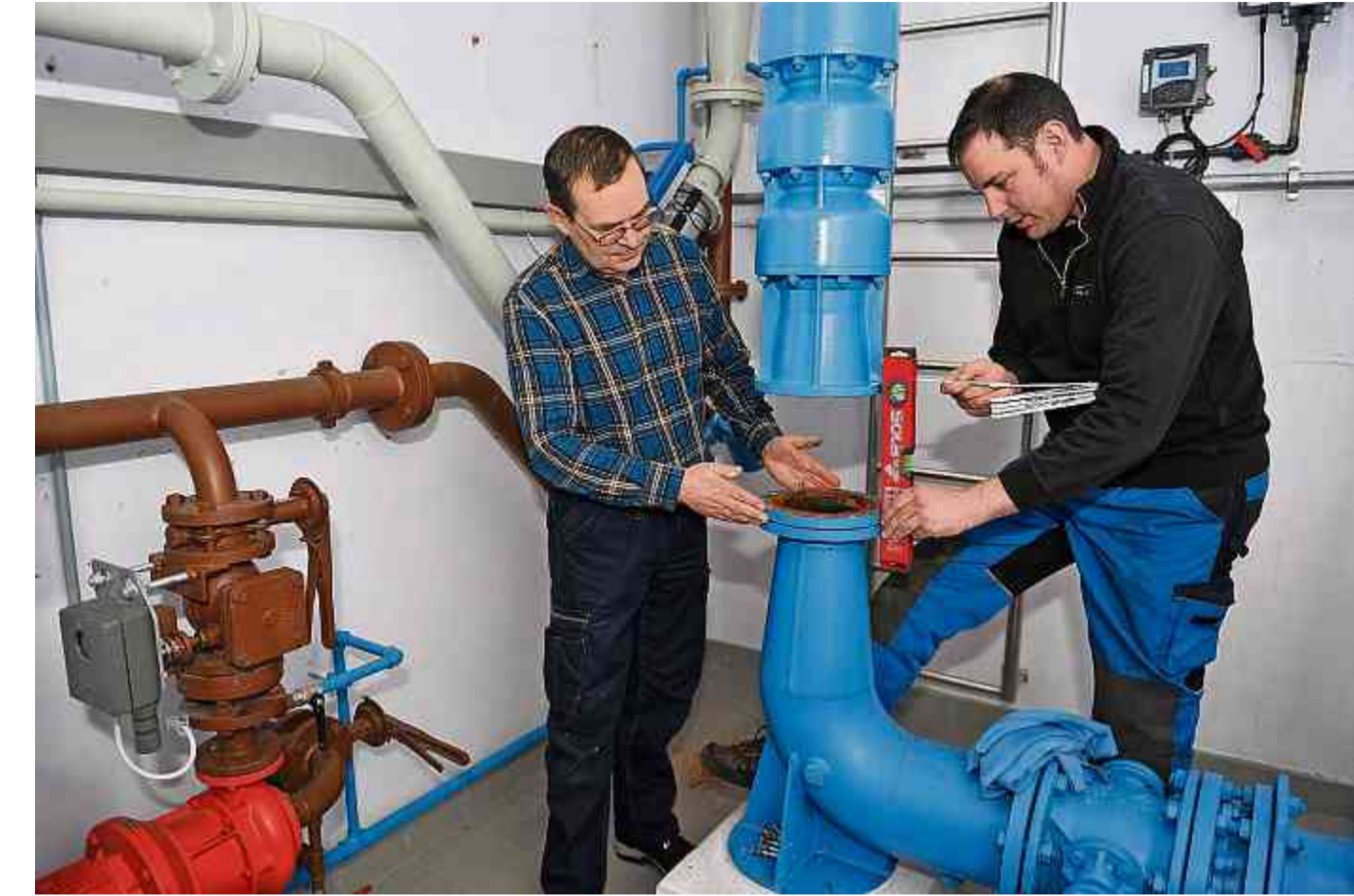
Hugo Egloff, Leiter Produktion Wasser bei den Technischen Betrieben Amriswil, und Monteur Rolf Steiner beim Einbau der dritten Pumpe.
